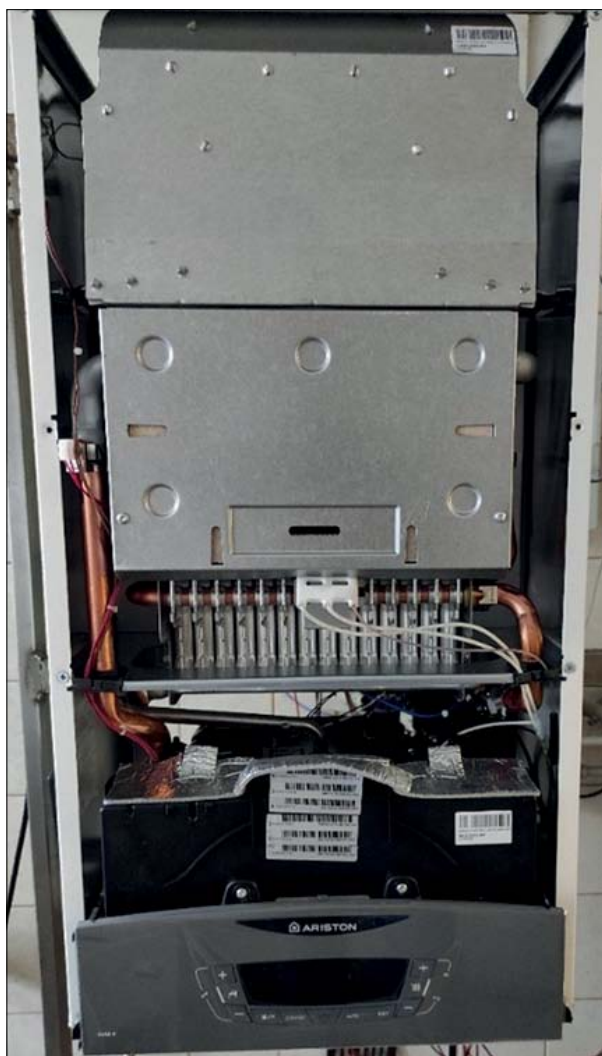
Rysunek 6. Widok wnętrza kotła gazowego nr 2 Figure 6. Interior view of the gas-fired heating boiler No. 2
