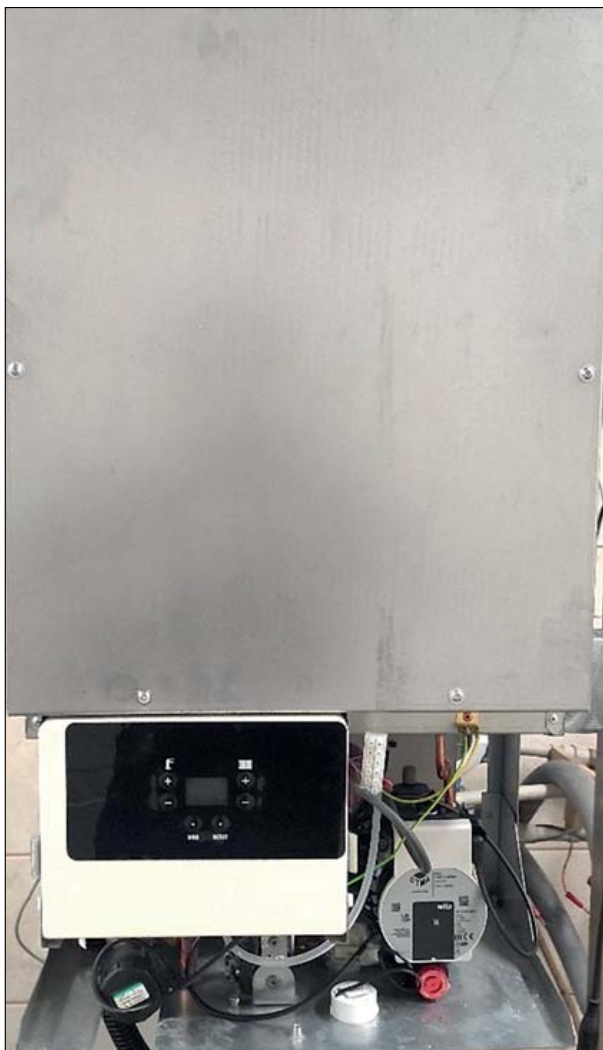
Rysunek 4. Widok wnętrza kotła gazowego nr 1 Figure 4. Interior view of the gas-fired heating boiler No. 1
